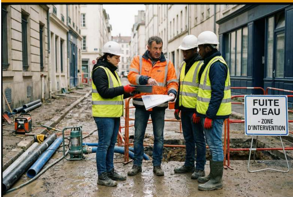
Briefing d'équipe sur intervention de 3 heures pour fuite d'eau
